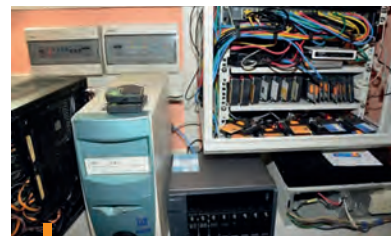
Zabezpieczony sprzęt elektroniczny
